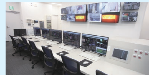
中央制御室 Central control room
