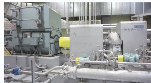
蒸気タービン発電機 Steam turbine generator
