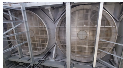
蒸気復水器 Steam condenser
